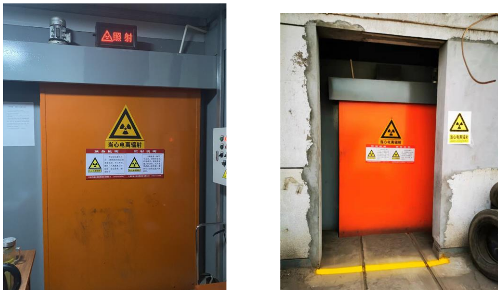
图 6-1 信号灯及电离辐射警示标志、警戒线
