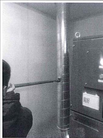
硫化粉尘排气筒进口
