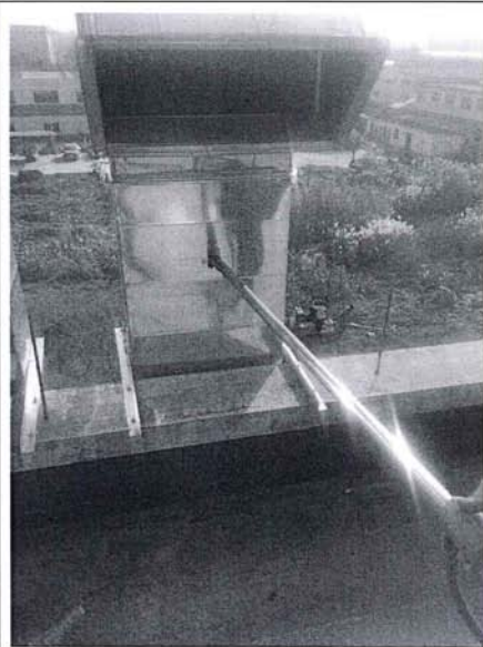
硫化粉尘排气筒出口
