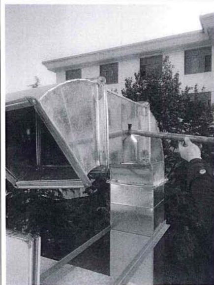
食堂油烟废气出口
