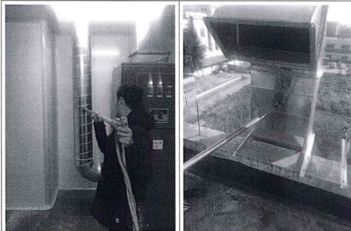
投料粉尘排气筒进口
